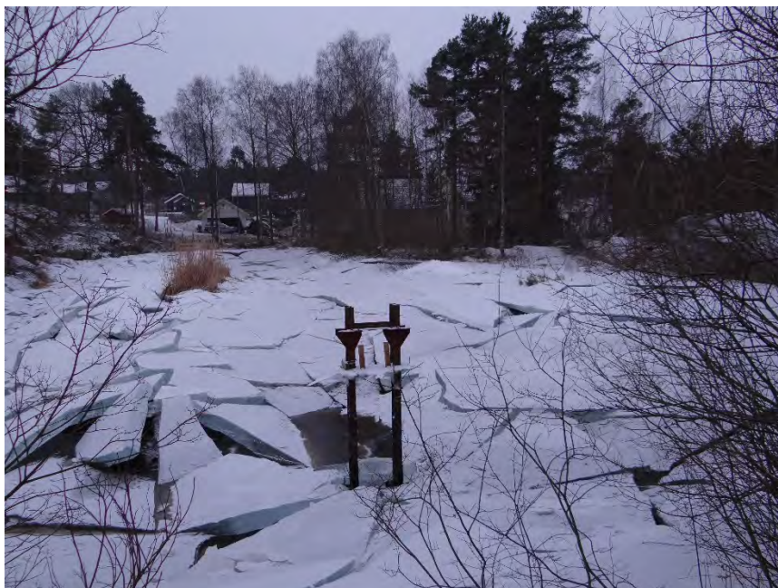
Dammen etter lekkasjene, vinteren 2012/2013.
