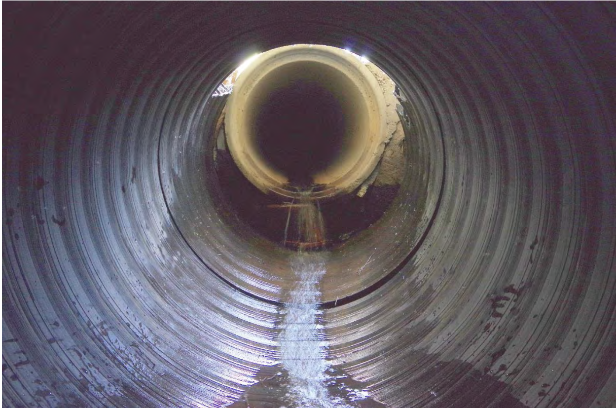
Fig. 3. Vandringshinderet mellom 1. og 2. kulvert danner et 40 cm direkte fall og må utbedres ved f.eks. å montere en form for «sklie» slik at fisk kan vandre opp! I nedre billedkant sees litt av kulpen hvor fisken har anledning til å hvile. (Foto: Amund Dahle).
