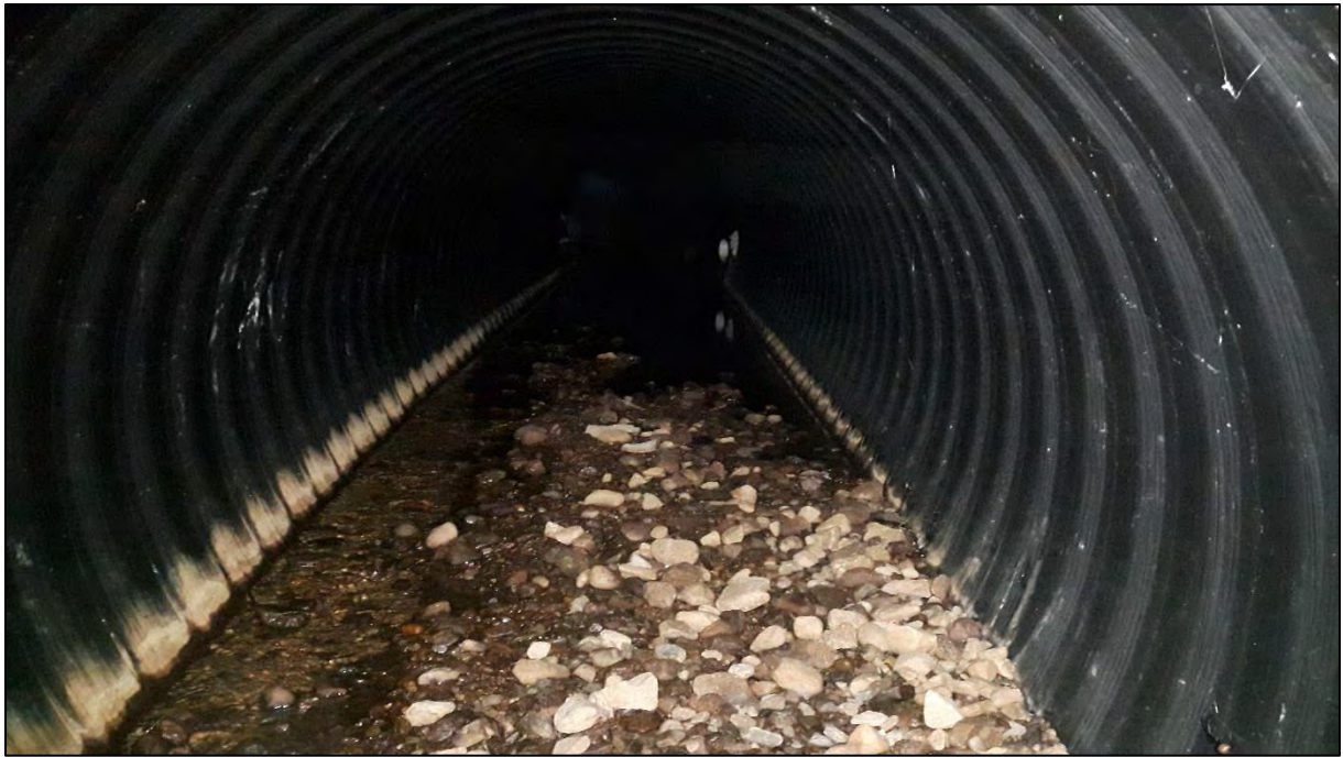
Fig. 5. Parti med gytegrus inne kulvert nr. 1. (Foto: Leif R. Karlsen)
