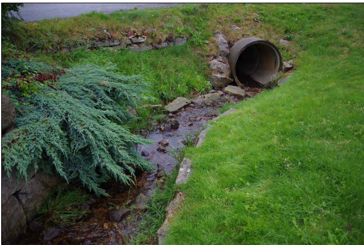
Fig. 9. Kulverten under fylkesveien er ikke til hinder for opp vandrende fisk. (Foto: Amund Dahle)
