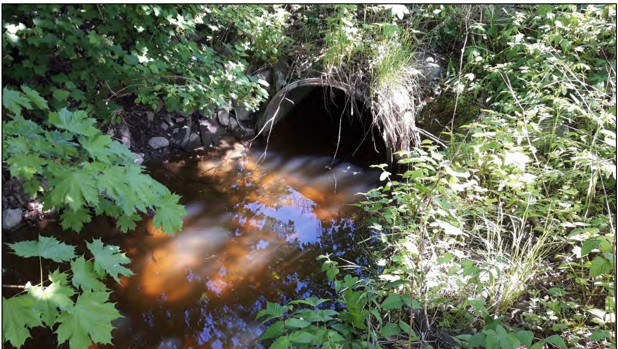
Fig. 11. Kulvert ved pumpestasjonen (P-14). Røret ligger dypt og fint.
