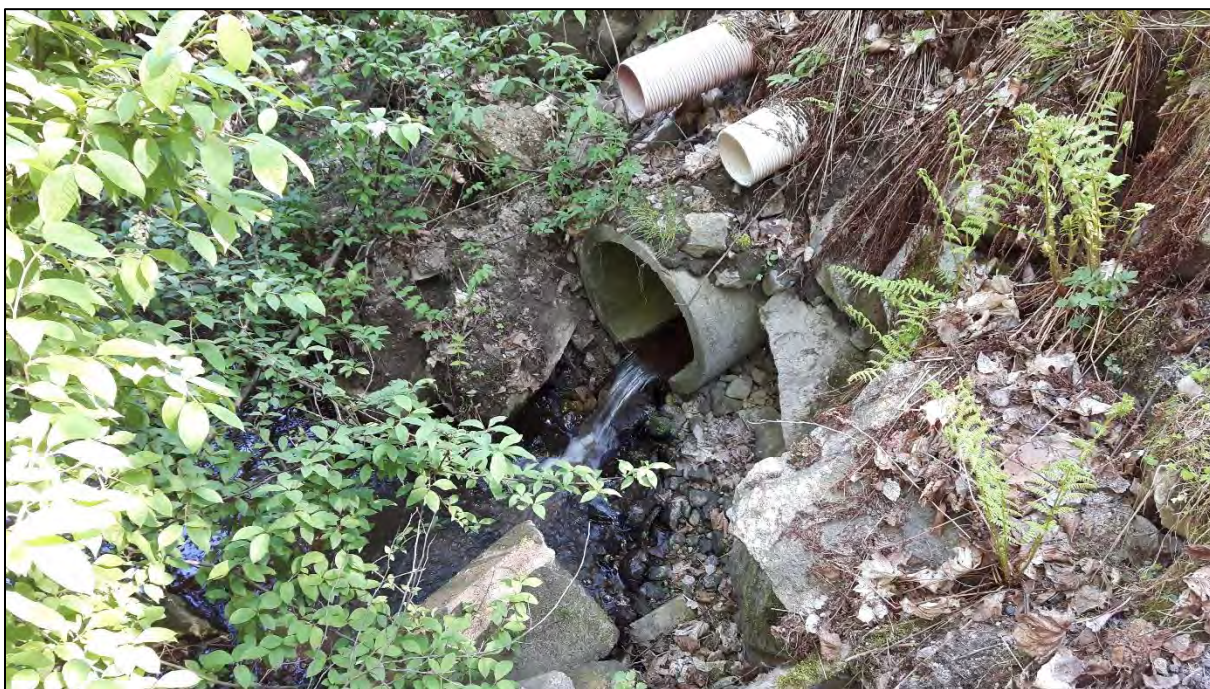
Fig. 15. Røret under infartsvegen til bolighus ovenfor Fv. 116 representerer et vandringshinder for fisk.
