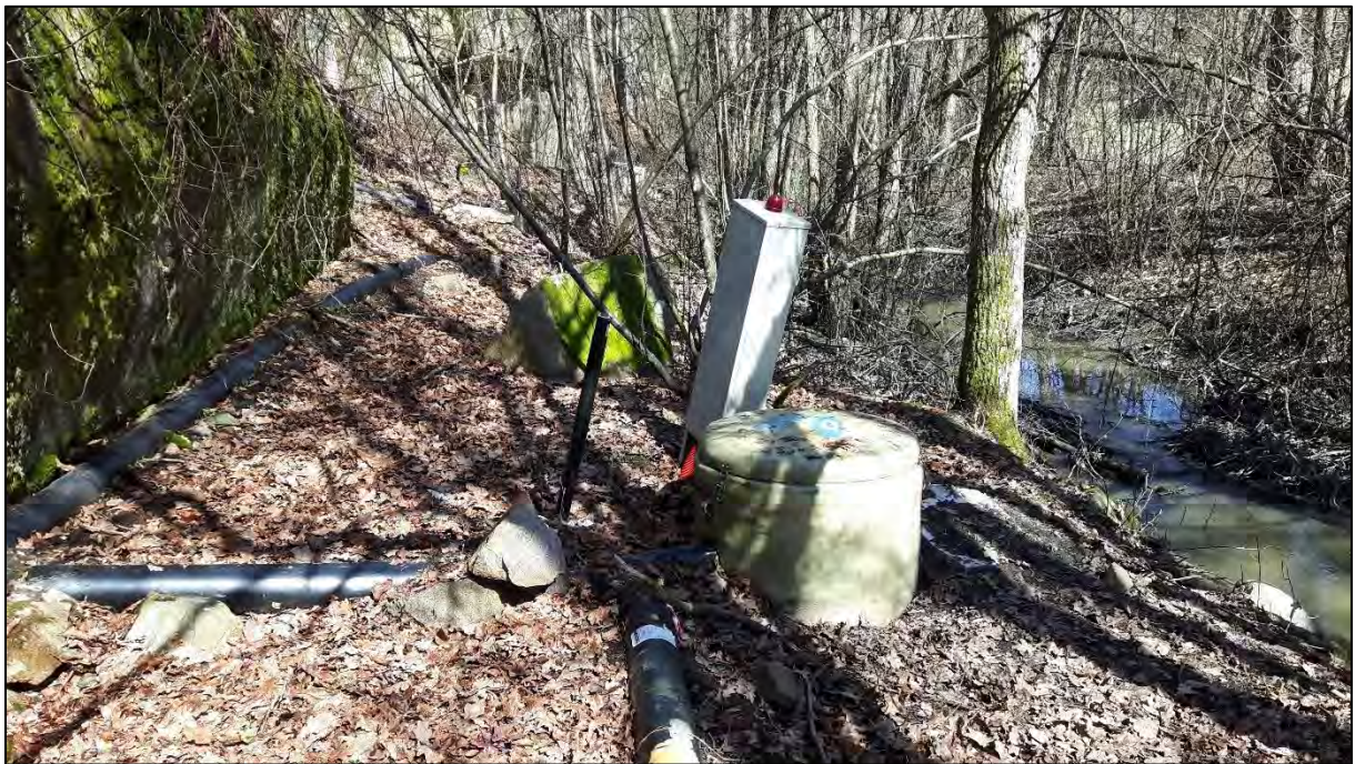
Fig. 14. Septiktank/minirenseslegg i nedre del av bekken.
