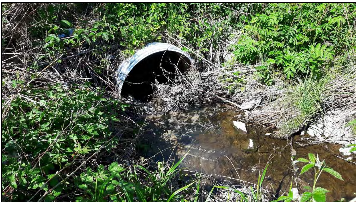
Fig. 12. Innløp til kulvert ved pumpestasjon var delvis blokkert.
