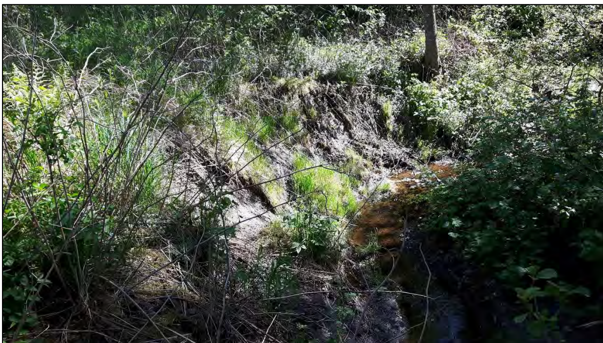
Fig. 21. Bekken graver ca. 20 meter ovenfor fylkesvegen, og bør steinsettes.
