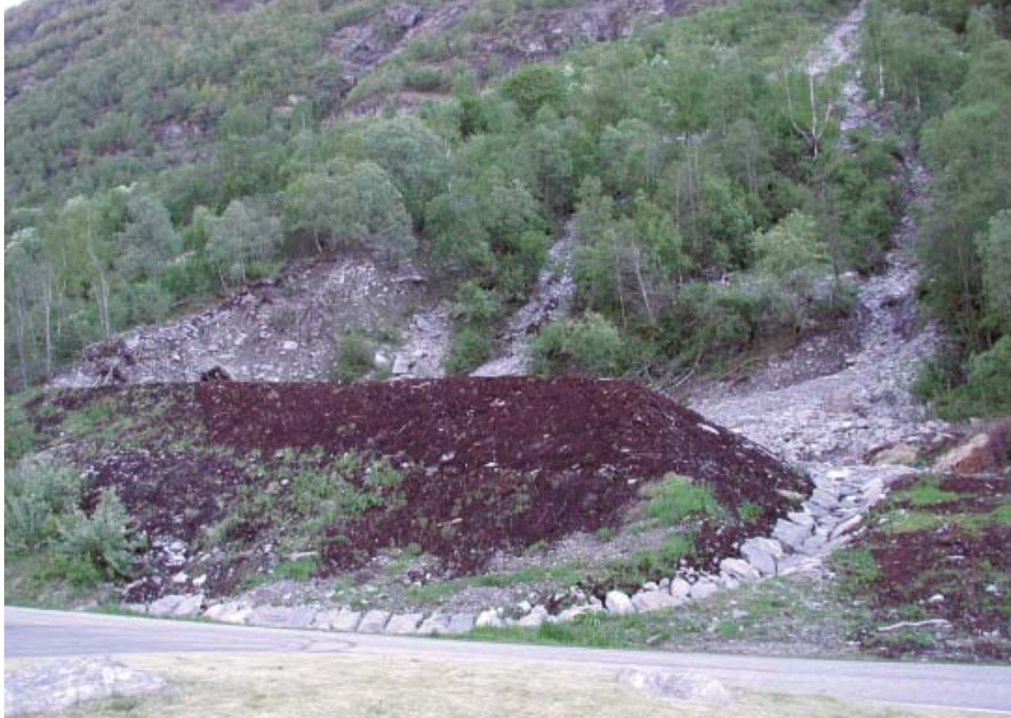
Rassikring i Grandestranda, Geiranger. Foto: Fylkesmannen i M & R
